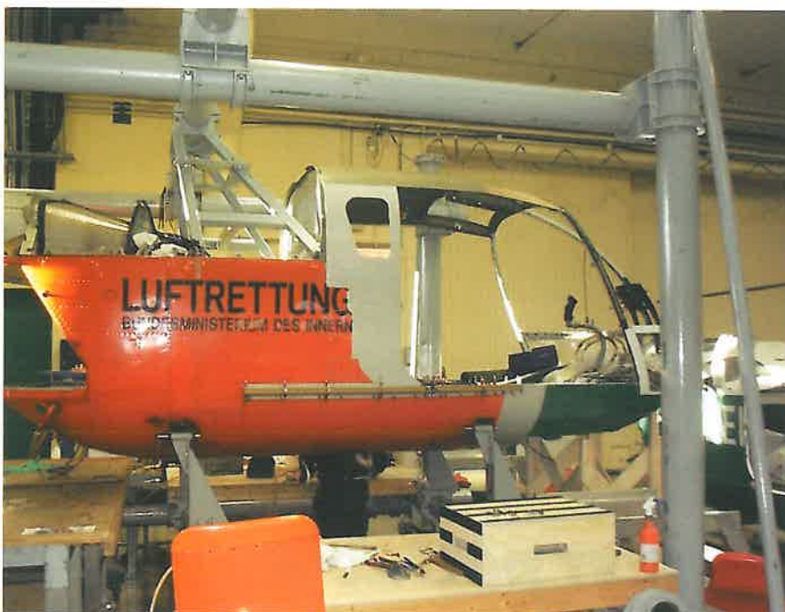
Två helikopterhalvor sammanfogas till en i reparationsjiggen vid AerotechTelub. Framkroppen från en f.d. tysk polishelikopter sätts samman med en helikopter som tidigare tillhört tyska inrikesministeriet. Foto: Lennart Karlsson, AerotechTelub.
